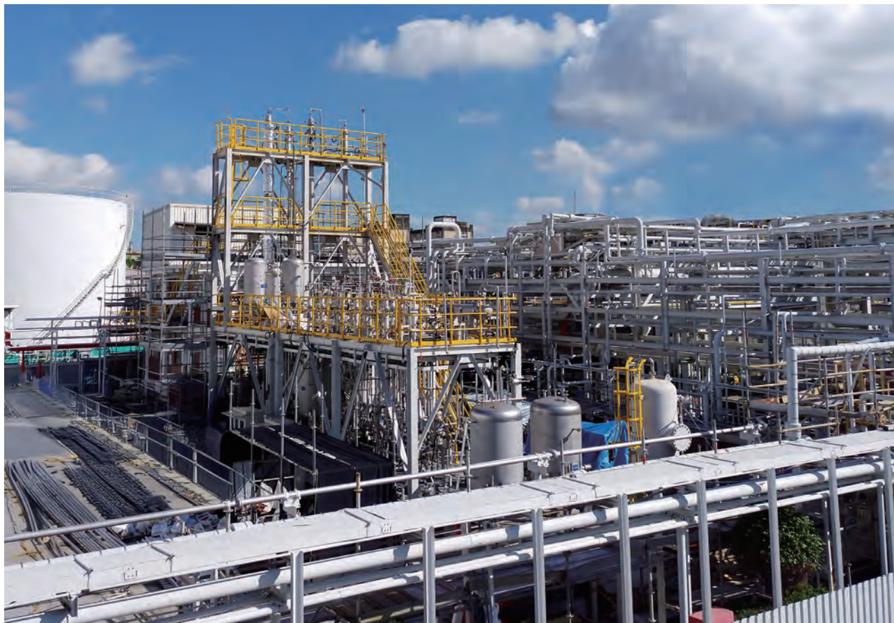
台塑仁武廠區煙道氣化學固碳試驗工廠
